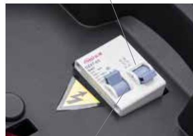
INTERRUPTORE GENERALE "OFF" BATTERIA 2
