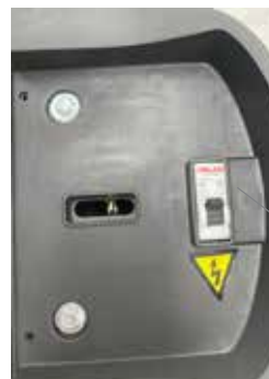
INTERRUTTORE GENERALE ON
