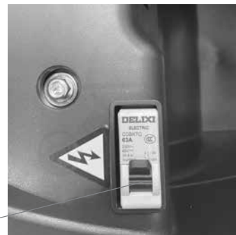
INTERRUTTORE GENERALE ON
