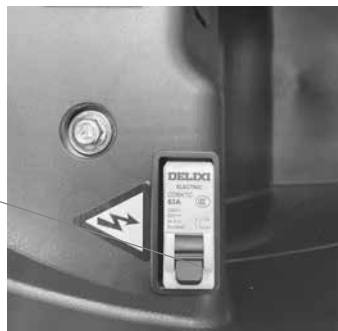
INTERRUTTORE GENERALE OFF
